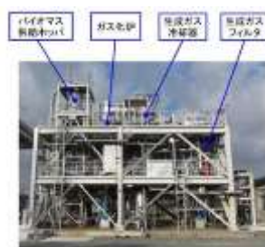
バイオマスガス化プラント
